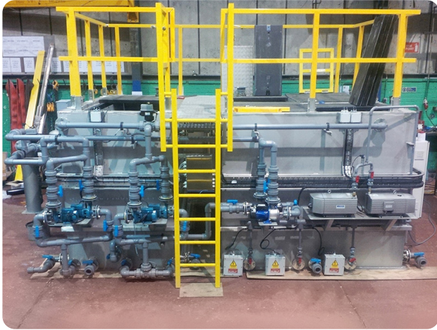
Sistema especial de tratamiento de aguas de esta planta
