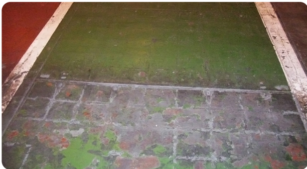
Raz zdjęta pokrywa betonowa nigdy nie będzie ponownie osadzona w ramie prawidłowo.
