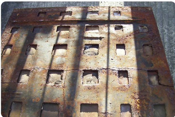
Poprzednio zainstalowane stare korodujące i pękające pokrywy betonowe.
