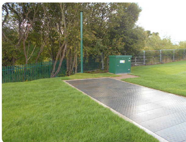
Każda pokrywa zainstalowana na obiekcie posiada zamek zabezpieczający przed otwarciem przez osoby niepowołane
