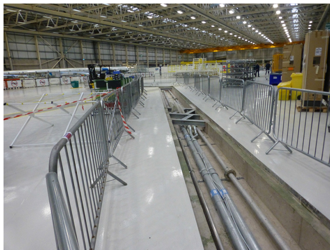
Tubazioni di servizio indispensabili per il processo produttivo
