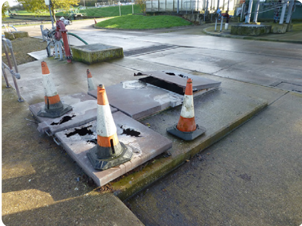
Die ursprünglich installierten, stark beschädigten u. korrodierten Stahlabdeckungen
