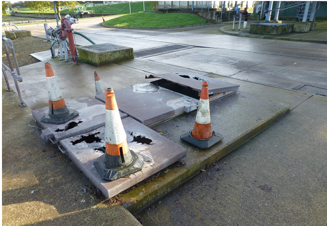
I pericolosi e corrosivi chiusini esistenti, realizzati in acciaio
