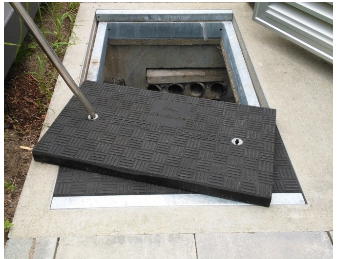
Pokrywy Fibrelite zainstalowane nad studnię kablową
